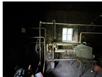
Katlu mājas iekšpuse
