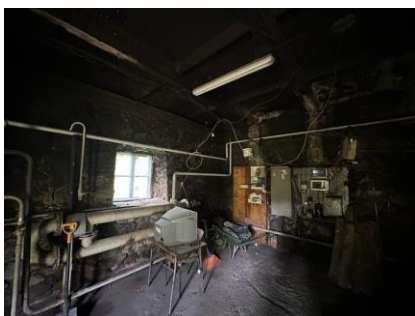
Katlu mājas iekšpuse
